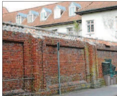
Auf der Mauerkrone fehlen die Schindeln, das Mauerwerk ist beschädigt. BILD: CORNELIA LÜERS
